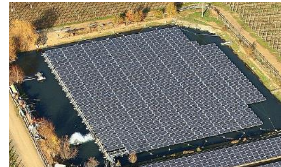
Quelle: © Wikimedia, SPG Solar ( https://commons.wikimedia.org/wiki/File:Floating_PV_system_Far_Niente_Winery_California_2018.jpg )
